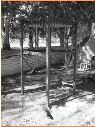
Fig. 7 - Estructura armada, con batea y bandeja instaladas
