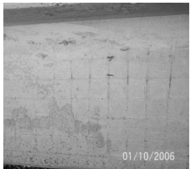
Fig. 12 - Escaso recubrimiento de la viga con apreciación de estribos. Puentes sobre el Río Purmamarca, Pcia. de Jujuy
