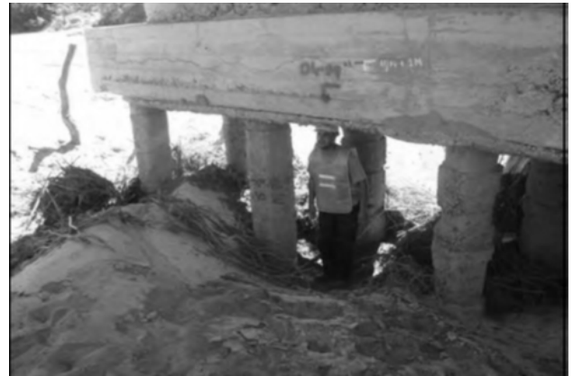
Fig. 6 - Socavación local en pila. Puente sobre el Río Talamuyuna, Ruta Nacional N° 38, Pcia. de La Rioja
