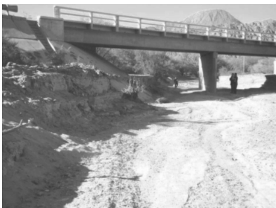
Fig. 5 - Erosión generalizada del cauce del Río La Puerta. Ruta 60, Pcia. de Catamarca
