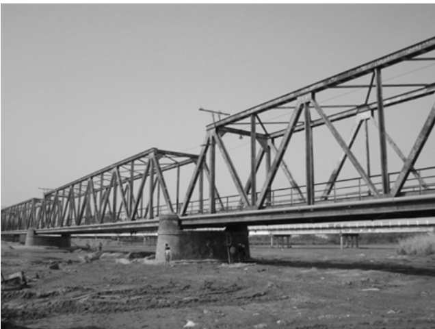
Fig. 2 - Puente metálico sobre el Río Gastona, Ex Ruta 38 (acceso Ciudad de Concepción, Tucumán). Longitud total: 353.50 m. Edad: 86 años. Principal patología: corrosión de nudos inferiores y tablero, descenso y rotación de una de las pilas
