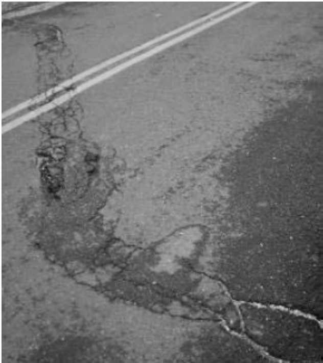
Fig. 13 - Carpeta de rodamiento asfáltica con fisuras y desprendimientos en el puente sobre el Río El Gato, Pcia. de Jujuy
