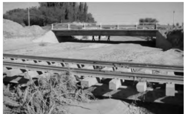
Fig. 7 - Azolve en Puente sobre el Dren Bofinger, Ruta Nacional N° 153, Pcia. de San Juan
