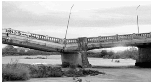
Fig. 15 - Falla por erosión local en pila. Puente Lucas Córdoba sobre el Río Salí, Ruta 9, Pcia. de Tucumán. Ejemplo ilustrativo extremo que no corresponde al grupo de puentes relevados.
