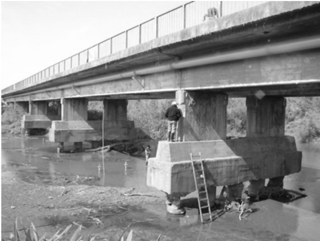
Fig. 1 - Puente de hormigón armado sobre el Río Pueblo Viejo, Ruta prov. 325, Tucumán. Longitud total: 101 m. Antigüedad: 42 años. Principal patología: Erosión generalizada del lecho del río con descalce de fundaciones
