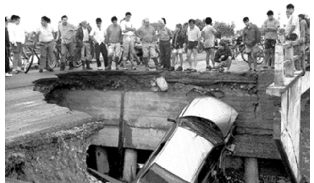
Fig. 8 - Erosión en terraplén de acceso, con estribo y fundación del mismo al descubierto. Ruta Nacional N° 38, Pcia. de Tucumán. Ejemplo ilustrativo extremo que no corresponde al grupo de puentes relevados
