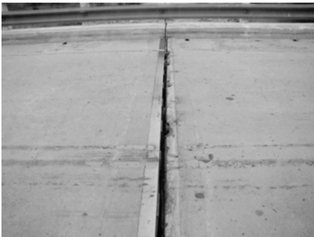
Fig. 14 - Junta de dilatación con perfiles metálicos faltantes en Puente sobre el Río Quines, Pcia. de San Luis
