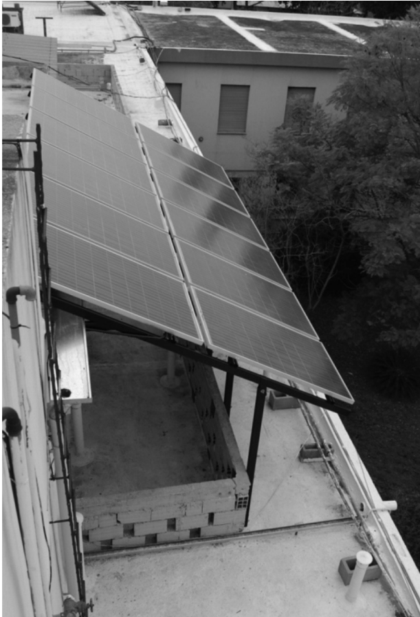
Fig. 1. Aspecto exterior de la instalación.
