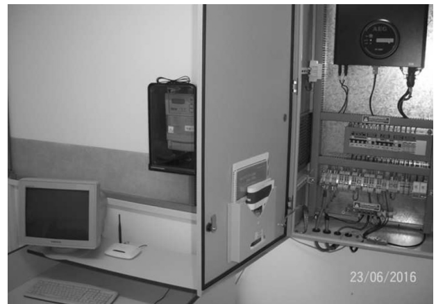
Fig. 2. Inversor electrónico y equipamiento accesorio.
