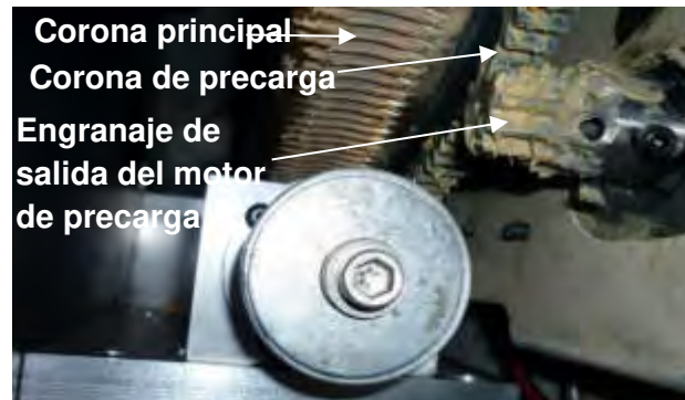
Figura 4 Coronas principal y de precarga, engranaje del motor de precarga de Ascensión Recta Telescopio HSH de CASLEO
