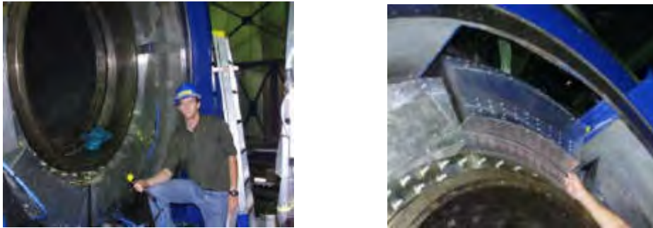
Figura 14 Instalación de los segmentos del estator de uno de los motores del accionamiento de elevación telescopio VLT- ESO Chile
