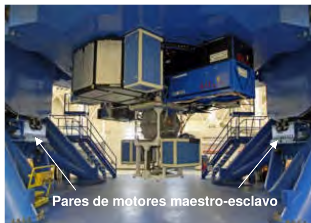
Figura 10 Motores del accionamiento de Elevación del telescopio Gemini South Chile
