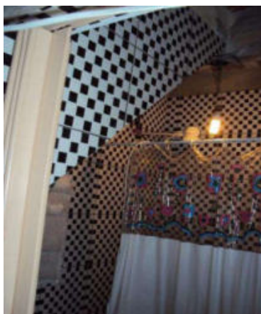
Figura 4. Revestimento cerâmico imitando pastilhas.
