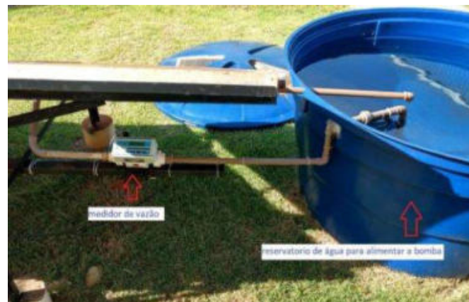
Figura 4. Detalhe do sistema de monitoramento da eficiência da placa.
