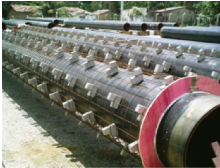
Figura 9 - Tubo com armadura convencional, Emissário do COMPERJ
