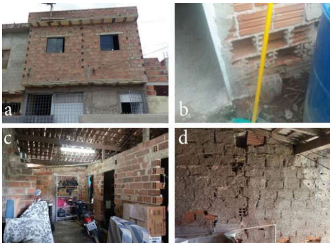
Figura 40. Trincas e problemas estruturais.
