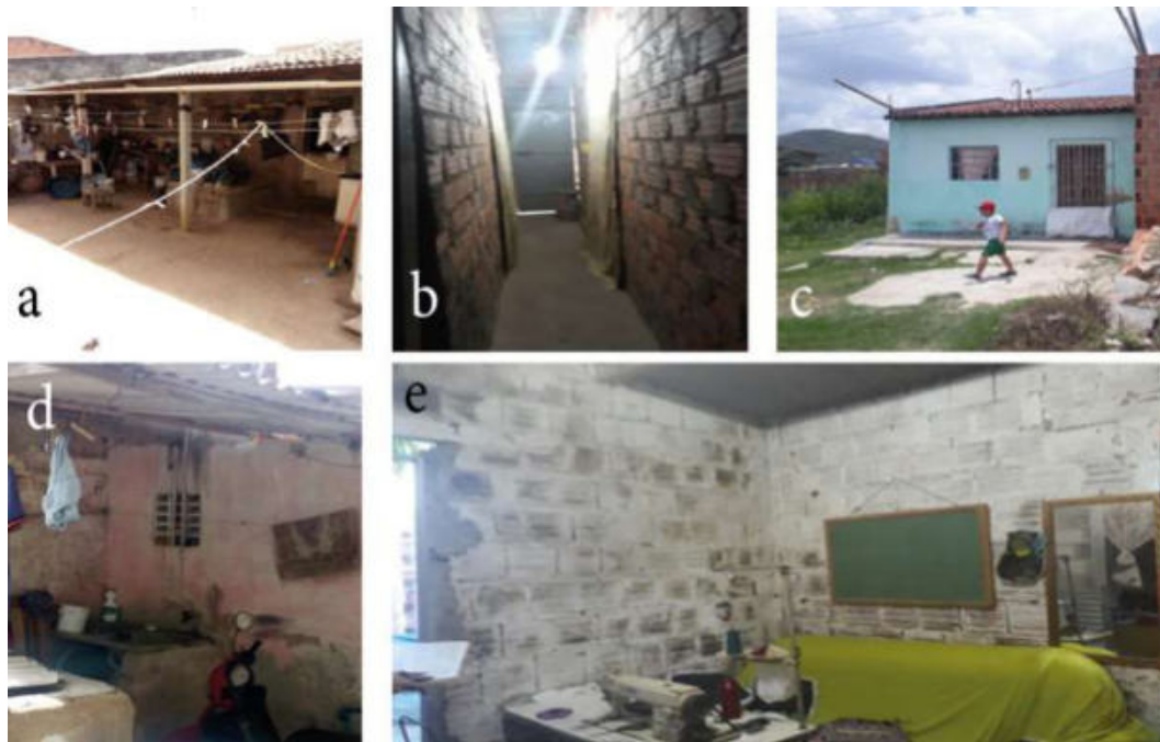
Figura 39. Iluminação e ventilação.
