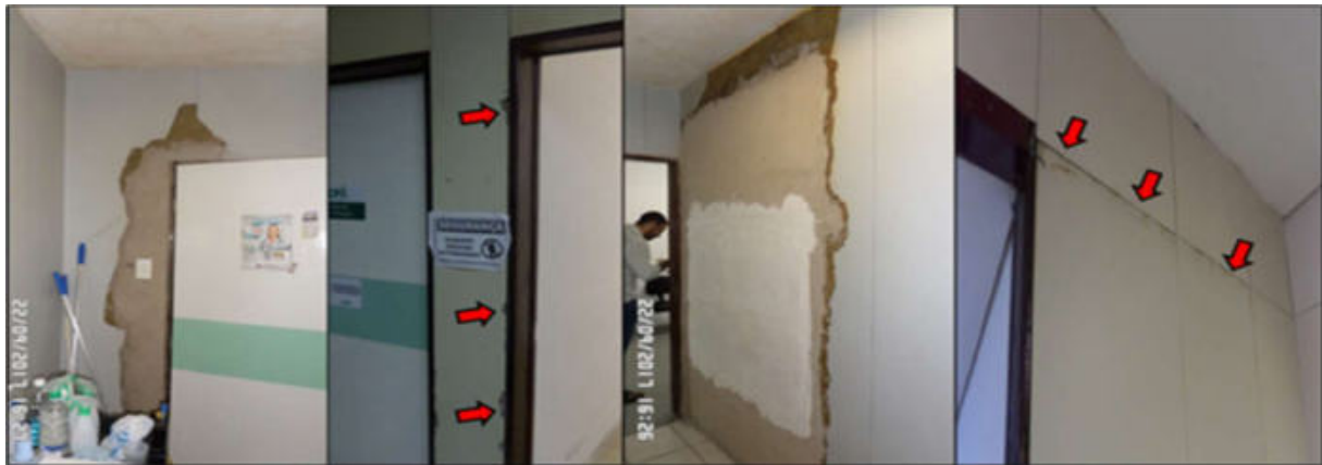
Figura 7. Problemas em paredes com acabamento em fórmica.
