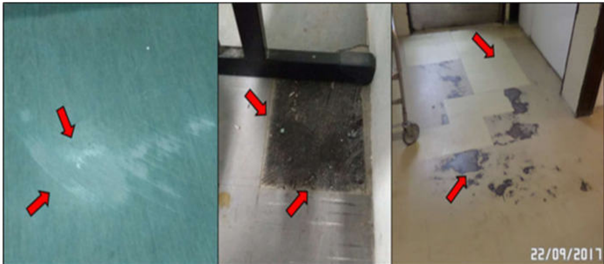
Figura 4. Problemas em piso vinílico.
