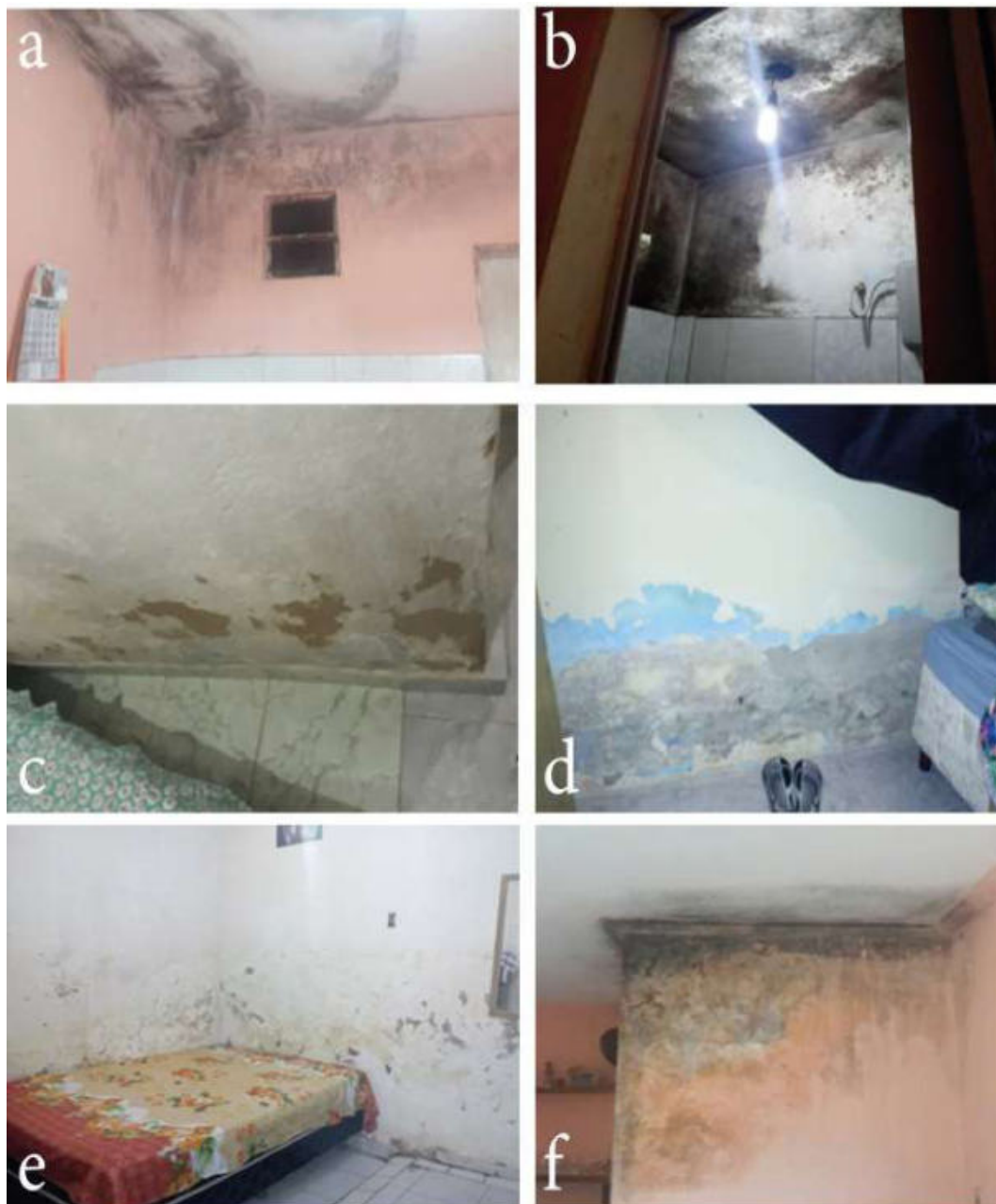
Figura 38. Infiltração e umidade.
