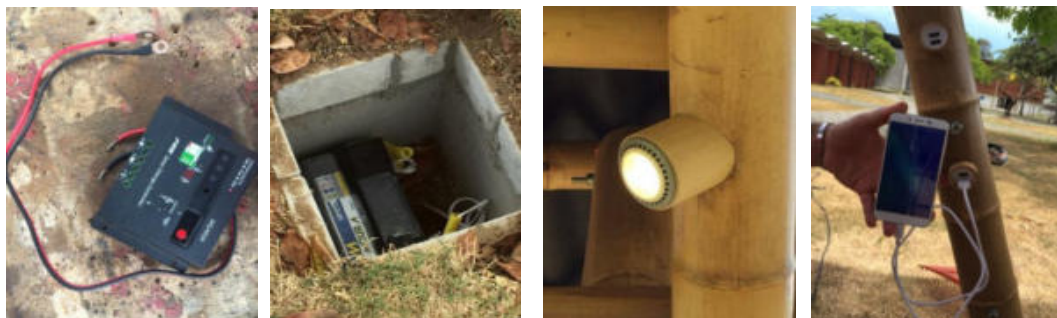
Figura 7. Instalação da bateria e controlador de carga e detalhe das instalações elétricas
