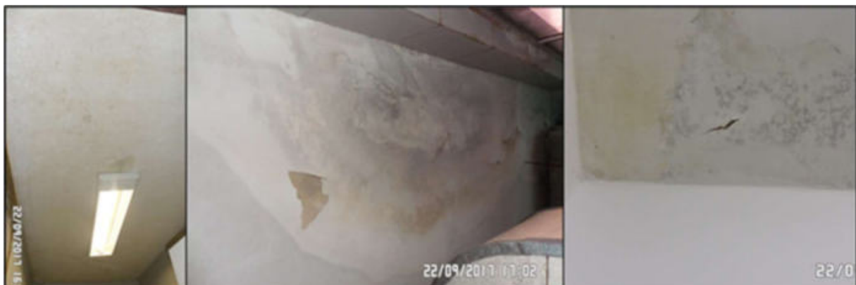
Figura 5. Problemas em teto de fundo de laje com pintura.
