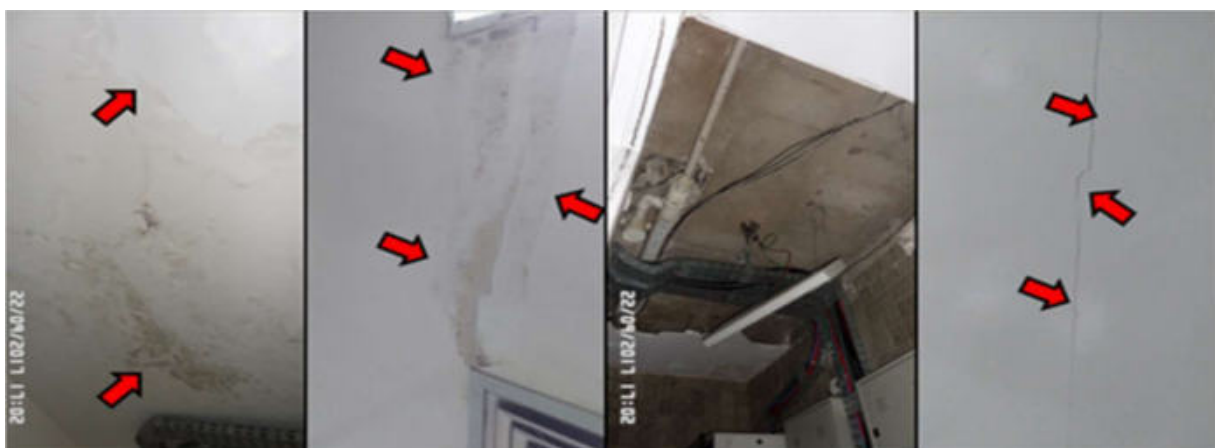
Figura 6. Problemas em teto com forro de gesso.
