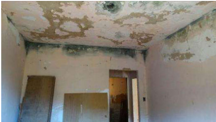
Figura 8. Exemplo de edificação de baixo padrão, com acúmulo de mofo em laje
