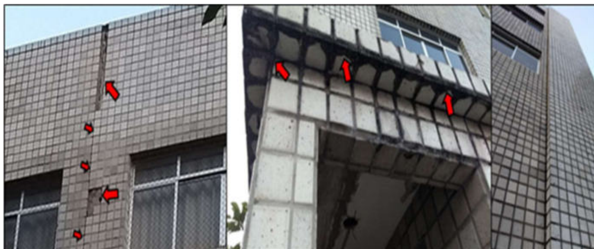
Figura 3. Problemas na fachada com acabamento em placa cerâmica.
