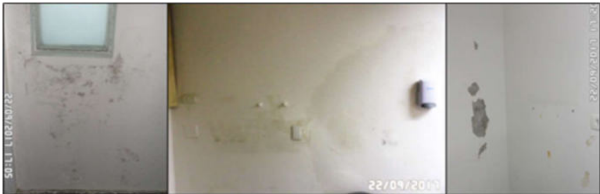
Figura 8. Problemas de umidade e destacamento em paredes com acabamento em pintura.
