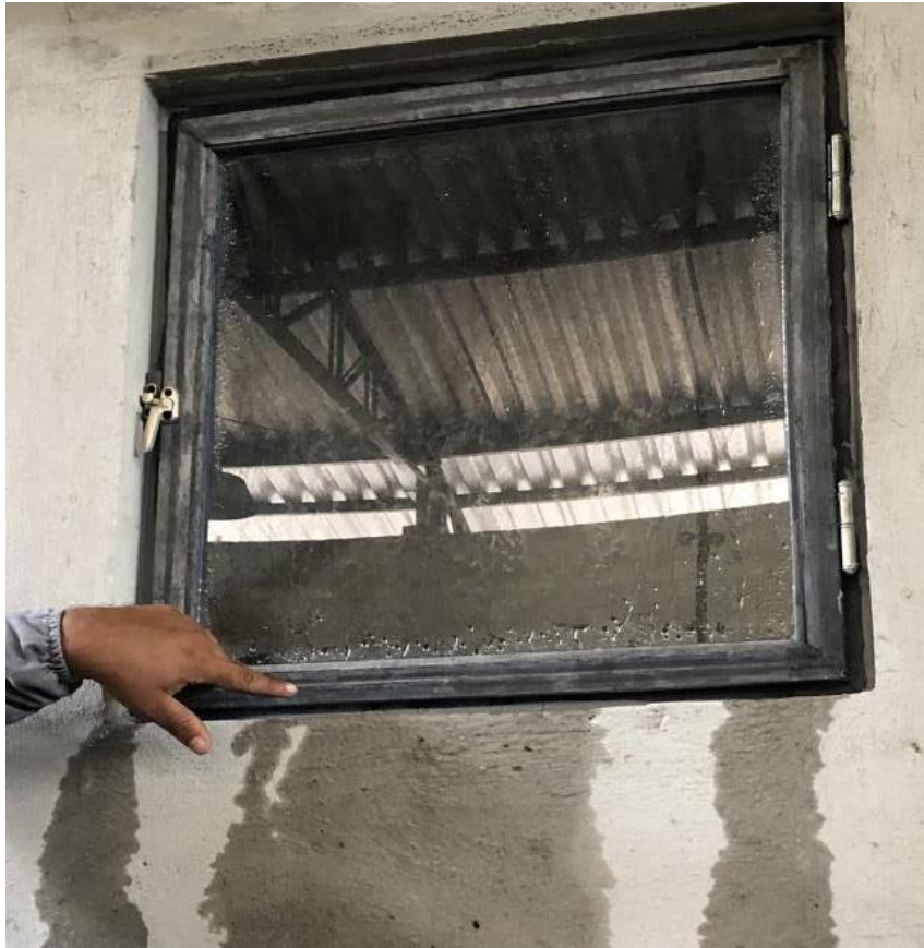
Figura 3. Esguerrimiento inferior sobre el plano interno de la cámara de ensayo
