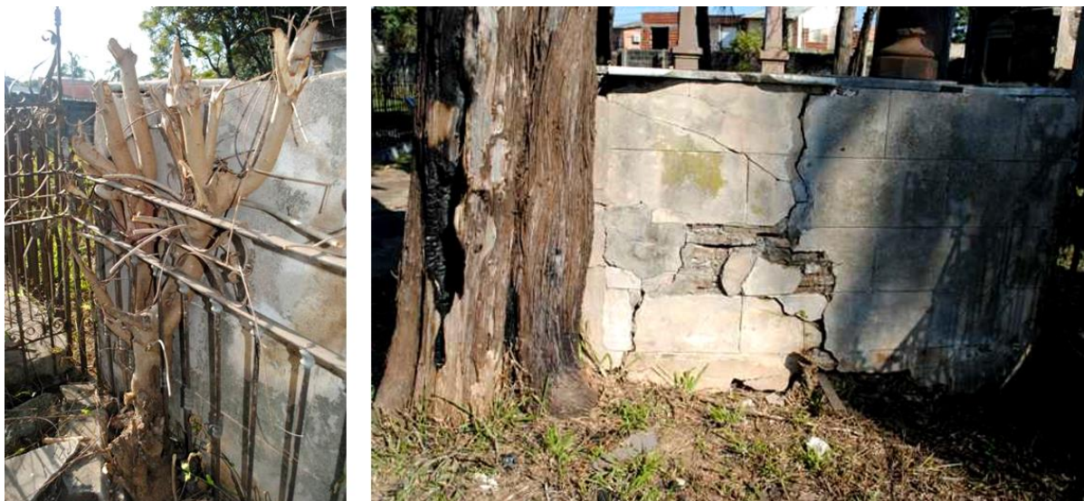
Figura 17. Fisuras en tumbas debido al empuje de arboles y arbustos.
