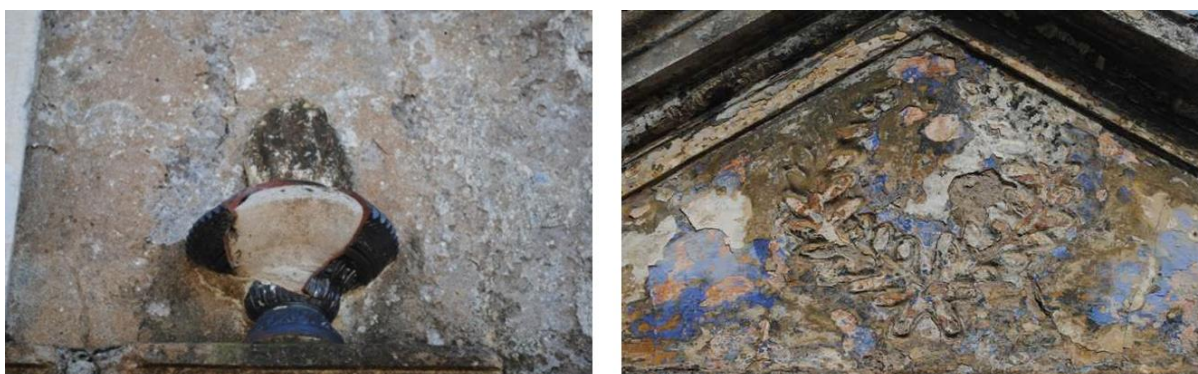
Figura 15. Restos de pintura en ornamenta de cerámica (izq.) y en el revoque exterior de un mausoleo (der.).
