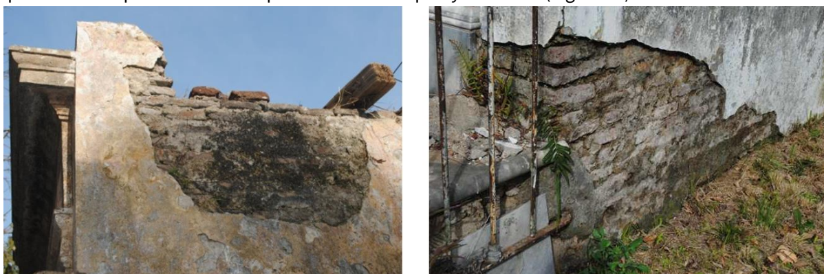
Figura 13. Desprendimiento de revoques en panteones.
