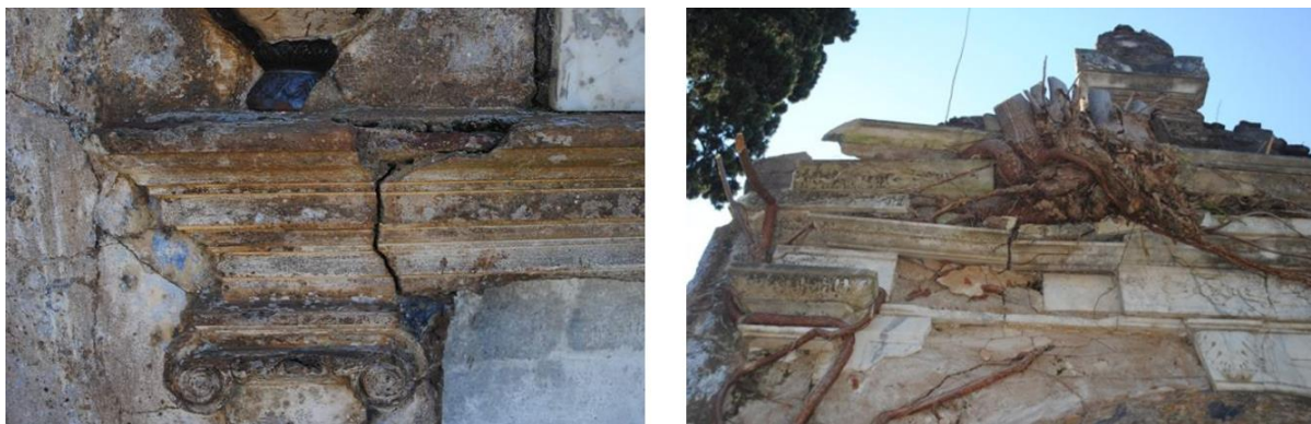
Figura 11. Presencia de fisuras en panteones. A la derecha se observan fisuras y desprendimiento de revestimiento debido a la acción mecánica de vegetación invasiva.
