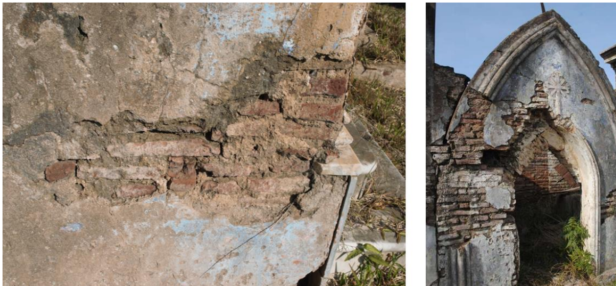
Figura 10. Alteraciones en mamposterías.
