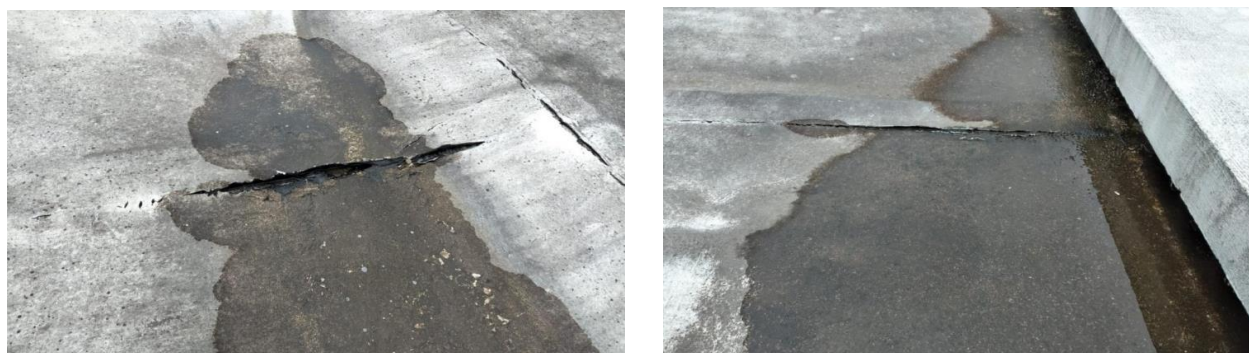
Figura 17| Situación de impermeabilización de la cubierta sobre sector 2
