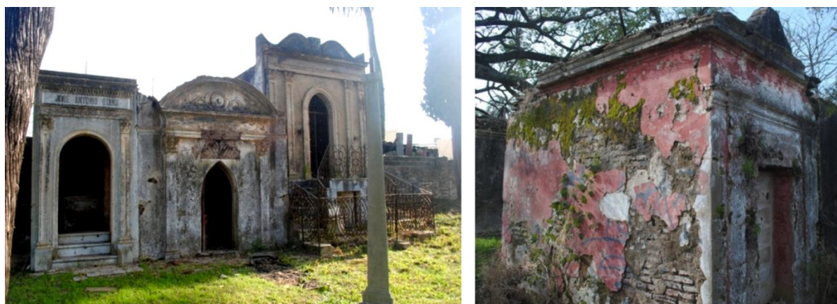
Figura 8. Panteones vandalizados. El panteón de la derecha fue sellado con un muro de ladrillos de cemento debido al robo de su placa de mármol.
