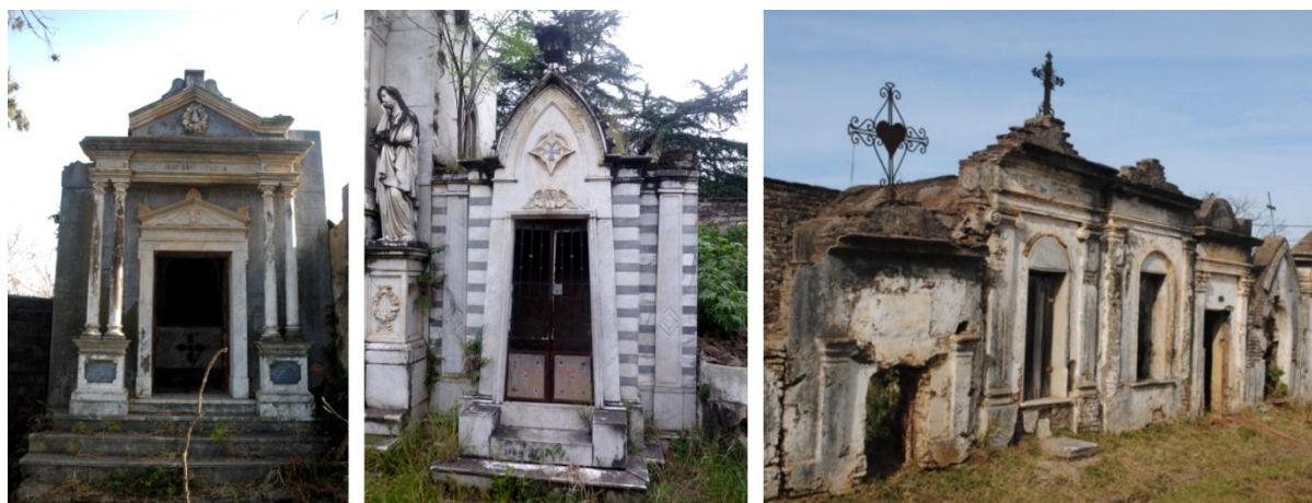
Figura 7. Panteones con el mayor grado de deterioro relevado.
