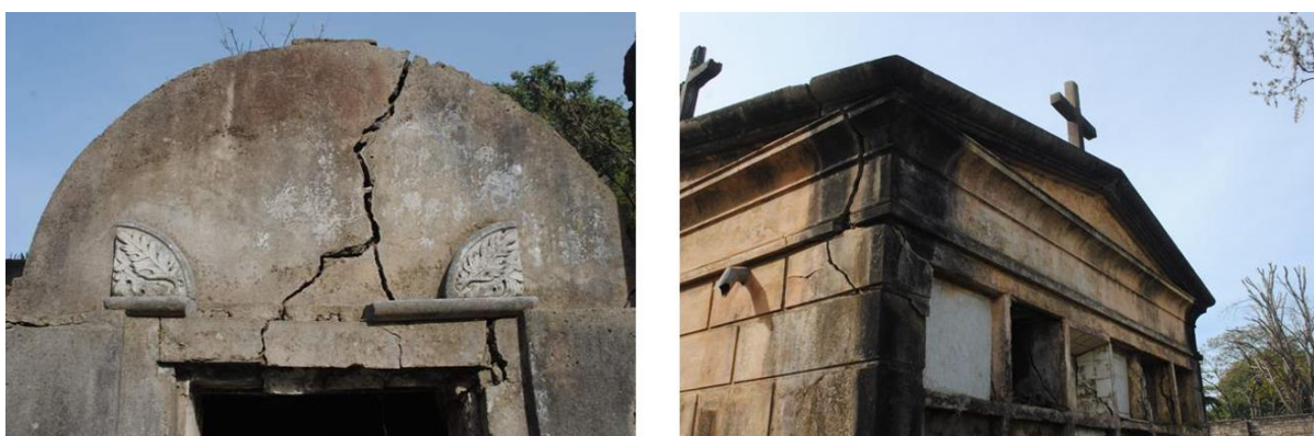
Figura 12. Presencia de fisuras en panteones.
