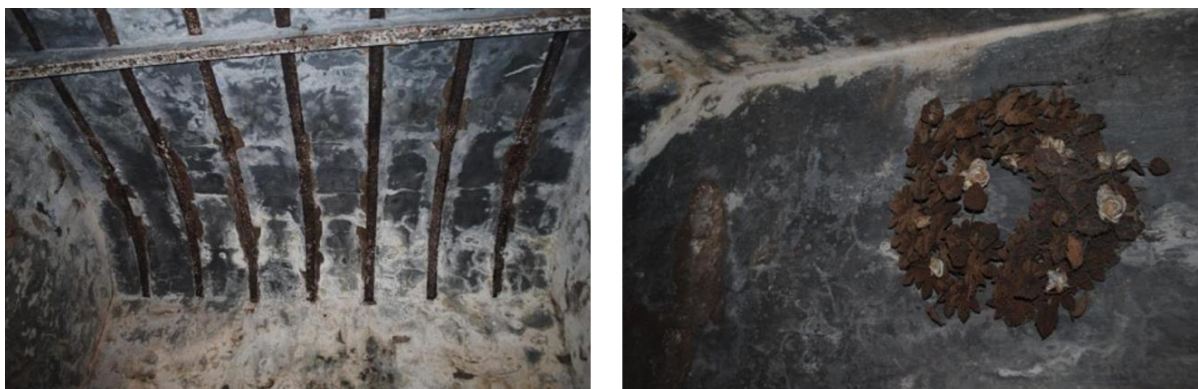
Figura 14. Procesos de corrosión en perfiles de bovedilla (izq.) y en elementos ornamentales (der.).
