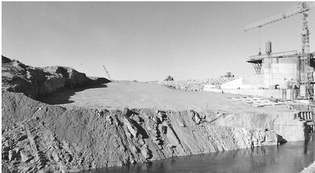
Figura n° 7. Foto que ilustra la sobre excavación del talud de margen izquierda del canal aductor de la Central Hidroeléctrica El Tigre. Di Salvo, (1979).
