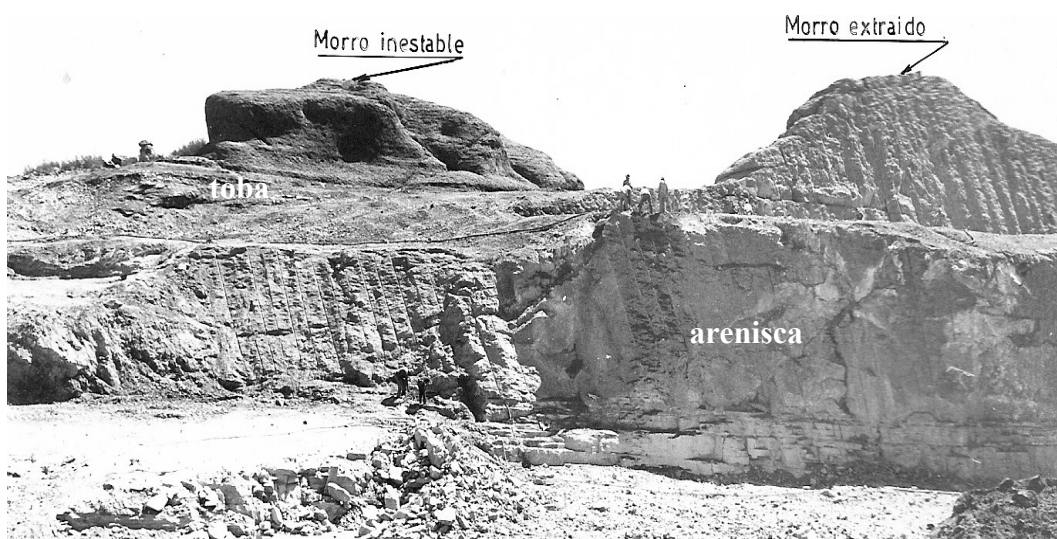
Figura nº 6. Morro inestable y morro que fue necesario excavar para estabilizar el talud.
