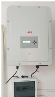
Figura 4, Imagen del inversor correspondiente a la instalación FV.
