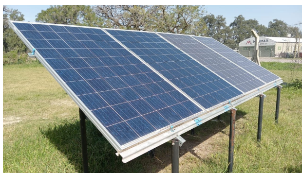
Figura 3, Instalación fotovoltaica con dos paneles limpios (izquierda) y dos con una capa de polvo (derecha).
