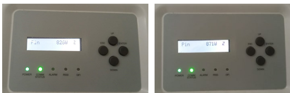
Figura 5 y 6, Imagen del valor de potencia instantánea de entrada del inversor correspondiente a la instalación con una capa de polvos y la otra en estado limpio respectivamente.
