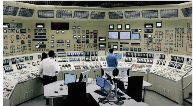
Fig. 5 Sala de control de una central nuclear
