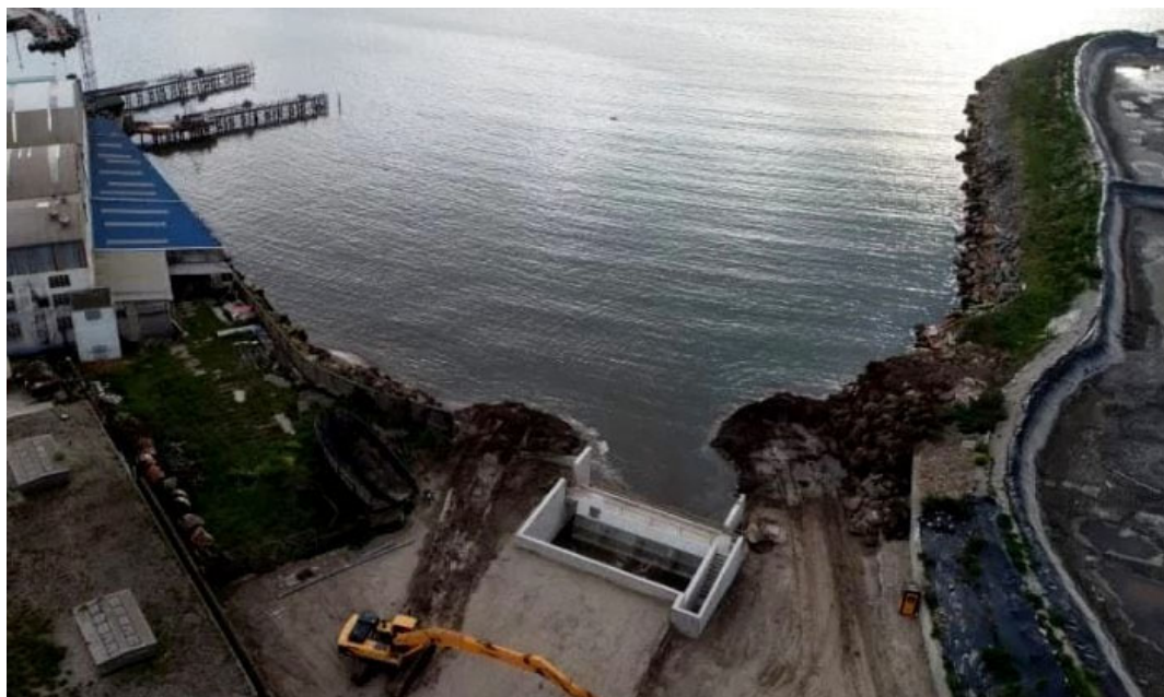
Figura 1. El Arroyo del Barco – Desagüe pluvial del puerto de Mar del Plata.
