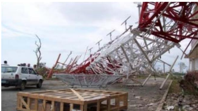
figura 1: Colapso de torre (Rodríguez Reinoso, 2015)
