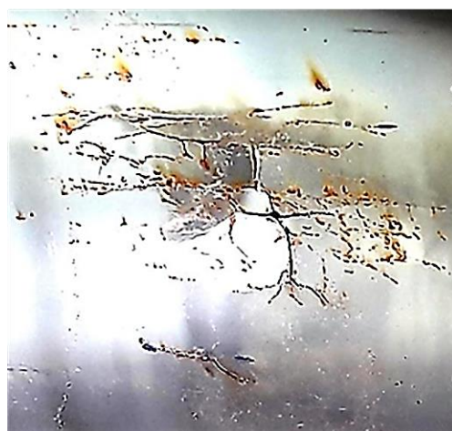
Figura 4: fisuras sutiles ramificadas y pasantes
