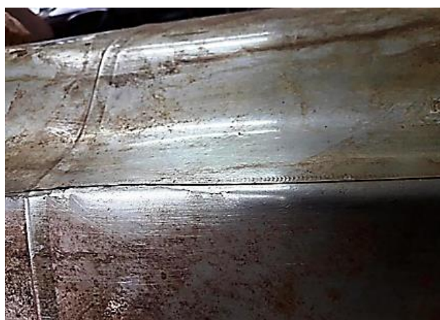
Figura 3: fisura adyacente a la soldadura longitudinal del cuerpo
