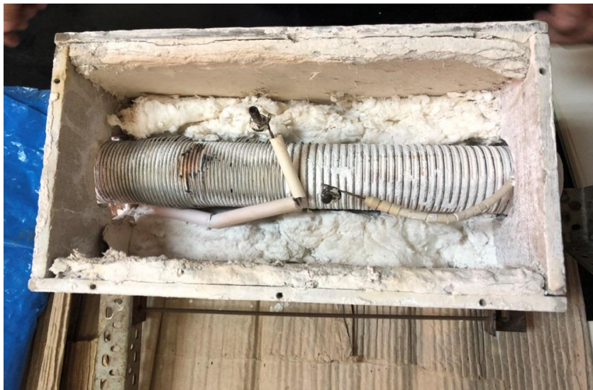
Figura 3: Foto del tubo de alúmina sinterizada dañado.
