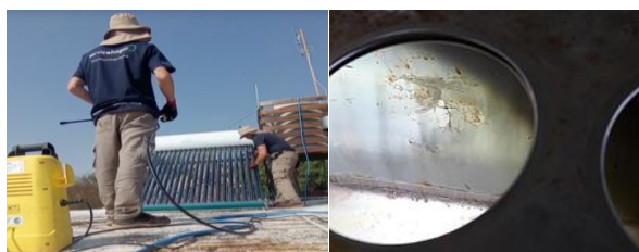
Figura 3: Mantenimiento, inspección y limpieza. Figura 4: Morfología del ataque corrosivo.
