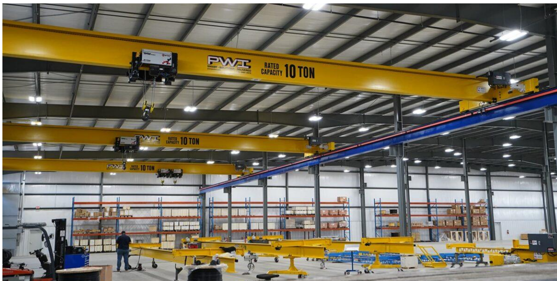
Figura 1: 3 grúas puente montadas en la misma estructura de rieles superiores
