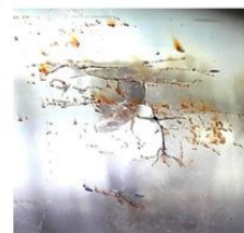
Figura 4: fisuras sutiles ramificadas y pasantes.
