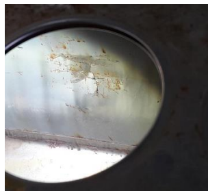
Figura B: inspección de la superficie interna de un tanque de ac. inox, 304 de EST, morfología de fisuras por SCC.
