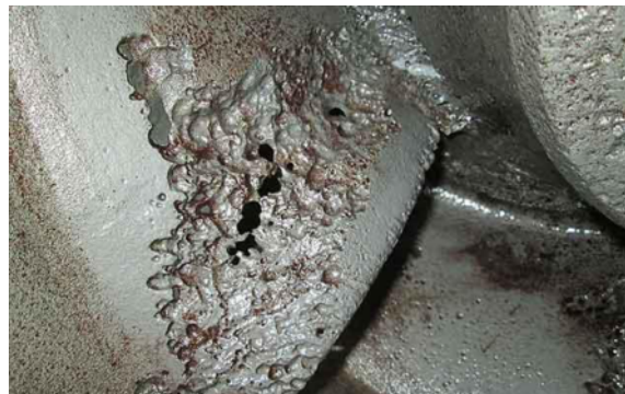
Foto 1: Aspecto de la erosión por desgaste de partículas solidas
