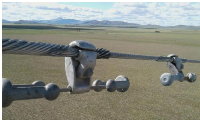
Figura 2: Detalle de una instalación típica de amortiguadores tipo Stockbridge.
