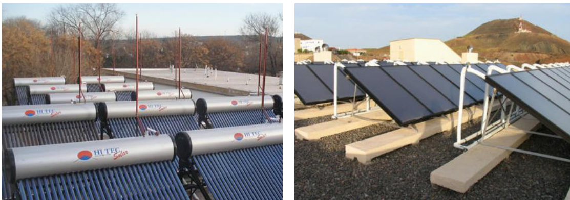
Figura 3: Instalación no recomendable de sistemas solares compactos (izquierda) e instalación de sistema solar forzado recomendable.
