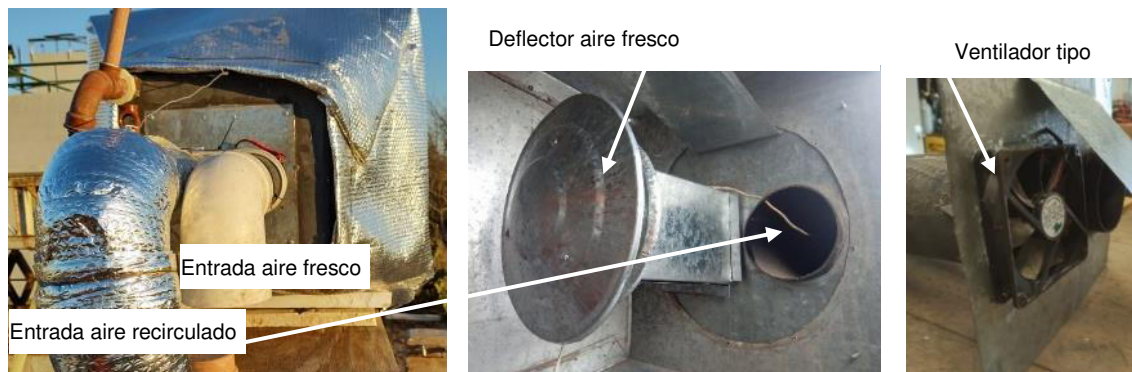
Figura 6: Ingreso de aire al equipo a) vista exterior b) vista interior del equipo c) ventilador
