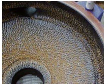
Foto 2: Aspecto de la corrosión en carcasa de BC
