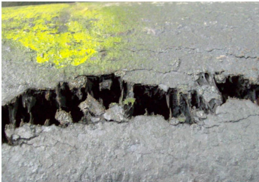
Figura 10: Fisura en el tubo, donde se observa el desgarramiento del material
