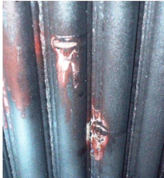
Figura 2. Daño en la zona de unión entre tubos
