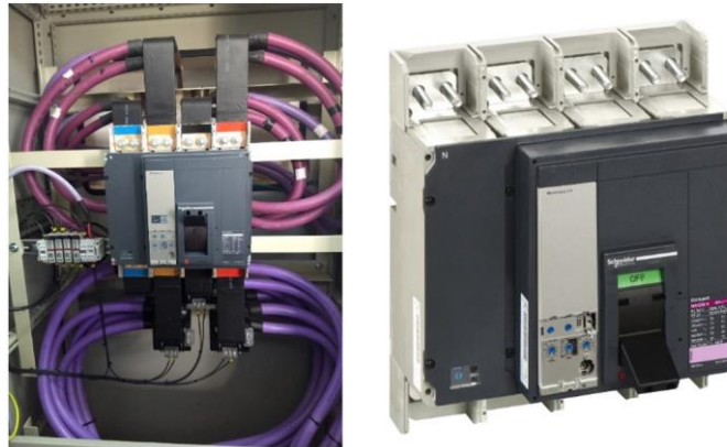
Figura 1. Tablero industrial para caso de análisis. Interruptor automático en servicio (izq.) e ilustración detallada del interruptor (der.).
